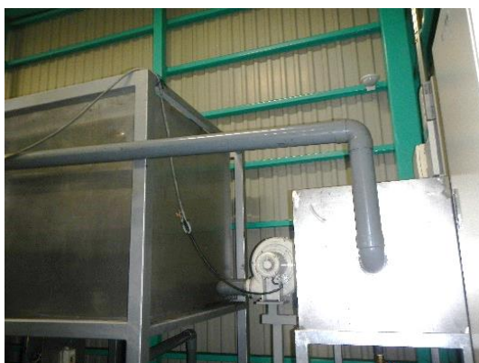
集じん機と脱臭装置
